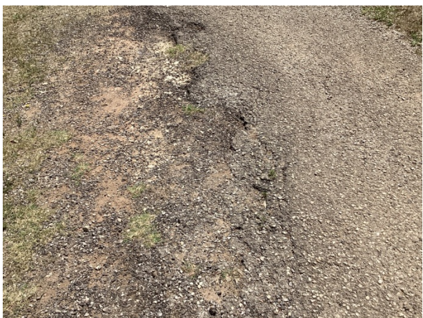
Walking path edge deterioration
